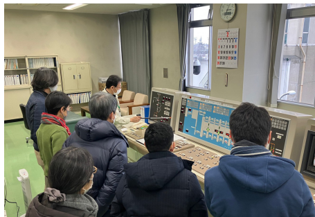
★操作車の様子、パネルにはポンプの運転状況が表示されており、ここで常時監視・操作を行う
